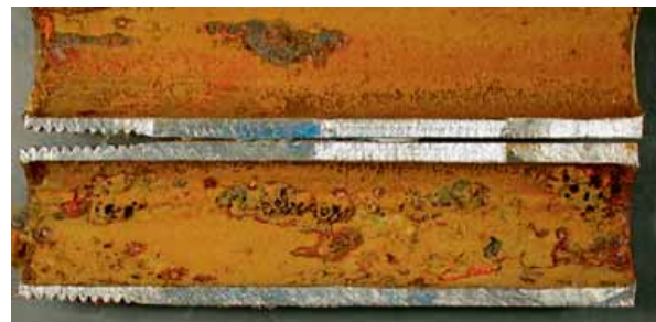
Stalowy przewód powrotny zimnej wody: korozja w stalowym przewodzie powrotnym zimnej wody
