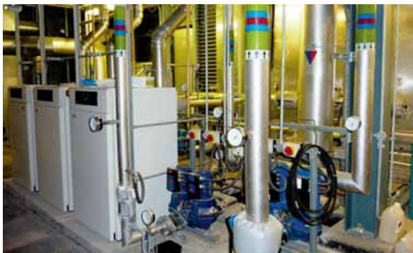
Typowe pomieszczenie instalacyjne przeznaczone dla instalacji wody niskoparametrowej i wody lodowej (szpital Addenbrookes w Cambridge)
