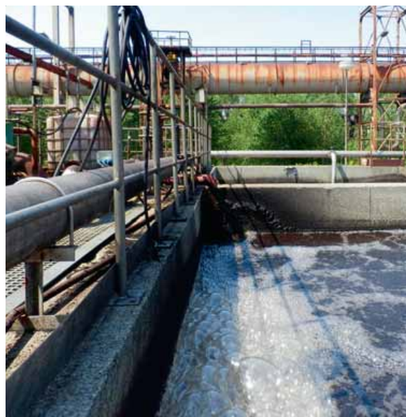
Zbiornik oczyszczalni ścieków
