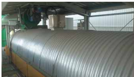
Układ skanera zamontowany na zewnętrzny, zamkniętym przenośniku z biomasą
